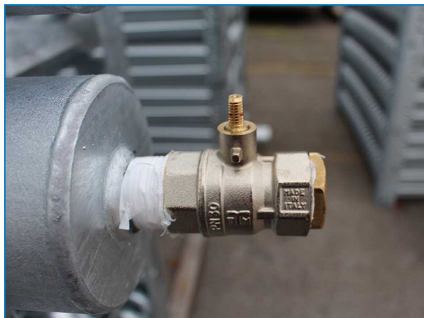
Соединение верхнего теплообменника с клапаном, стравливающим давление, на конденсаторах.
