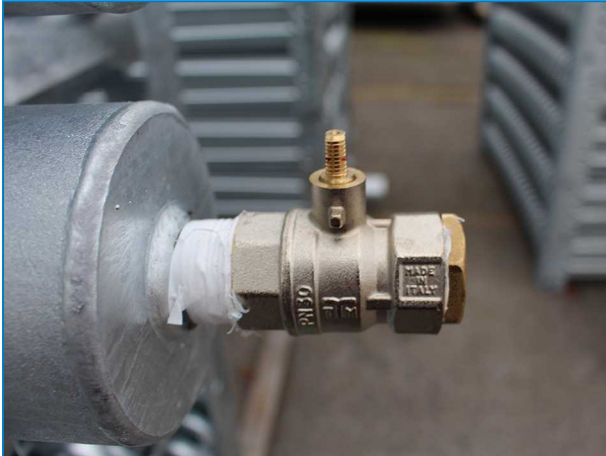
Oberer Rohrbündelanschluss mit Überdruckventil auf Verdunstungsverflüssigern.
