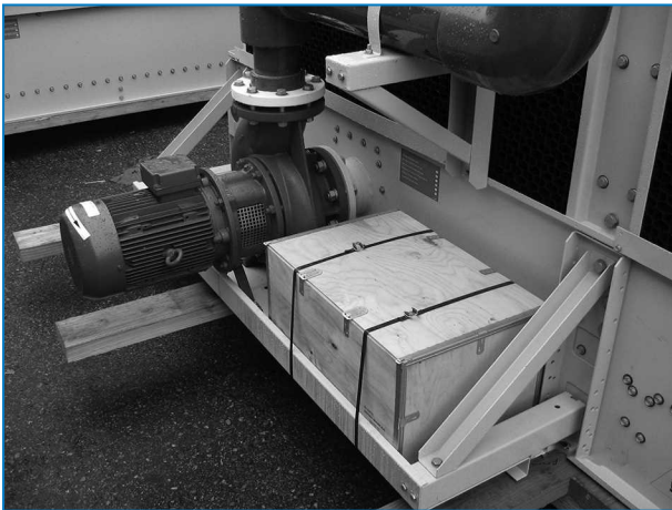
Ort des Montagematerials
