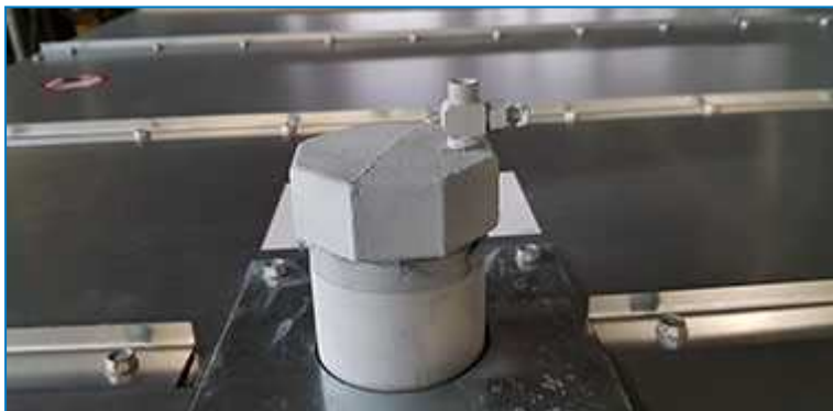
Attacco batteria chiusura su unità ad accumulo termico
