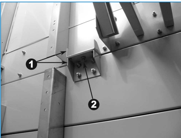
Sección de plenum instalada en la sección inferior
