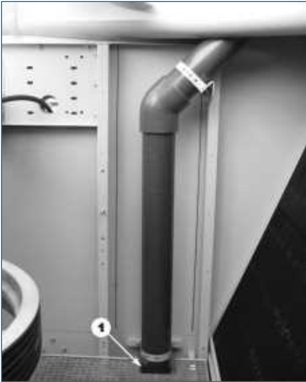
Interior de la sección de plenum de la tubería de la bomba
