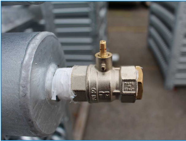
Raccord de batterie supérieure avec soupape de décharge sur les condenseurs.
