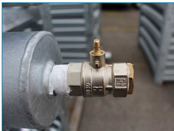
Raccord de batterie supérieure avec soupape de décharge sur les condenseurs.
